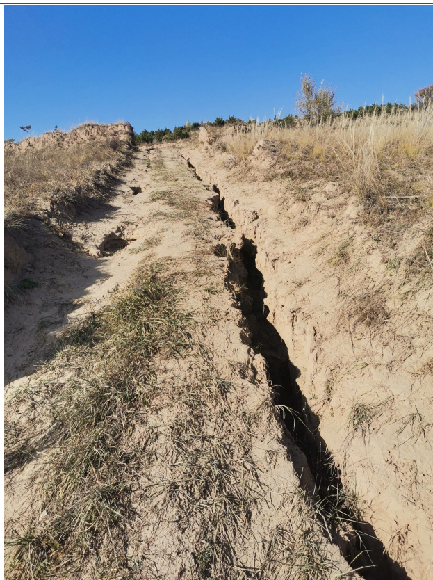
照片 4-1-2 塌陷损毁道路
